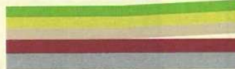
塗膜層間での剥離
